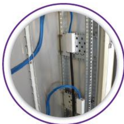
> Arrimages de câbles
